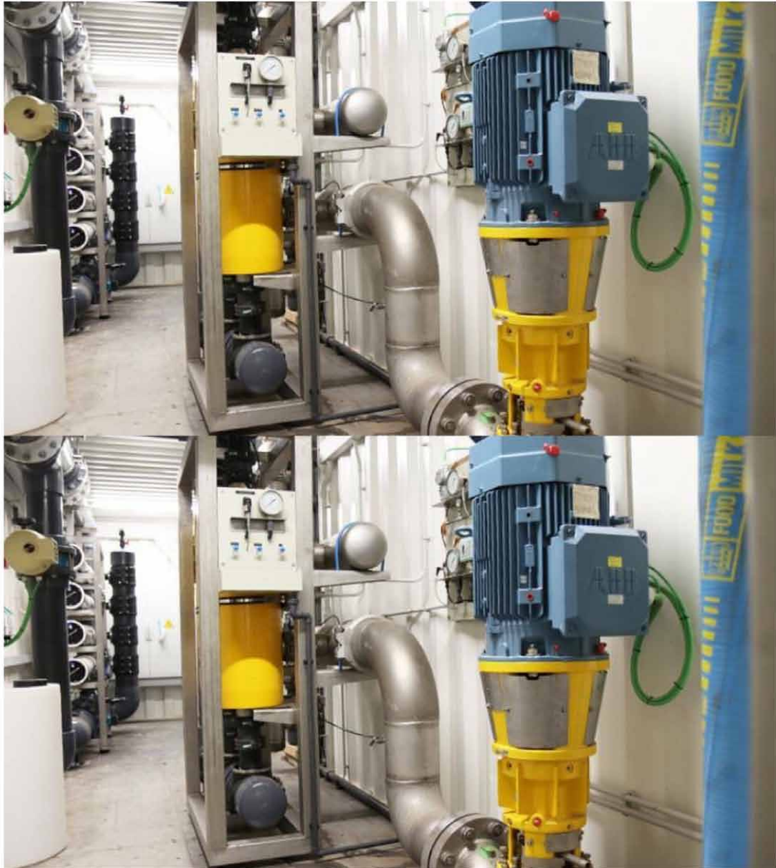
El interior de la desaladora. (Cedida)
