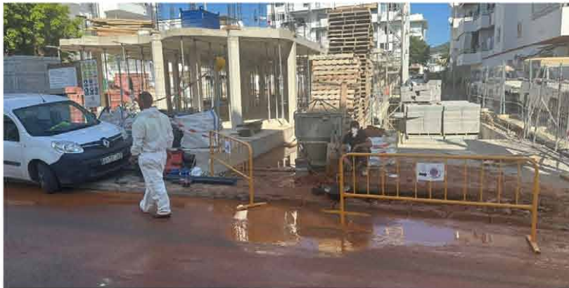
Calle afectada por la rotura de la tubería de suministro de agua.
