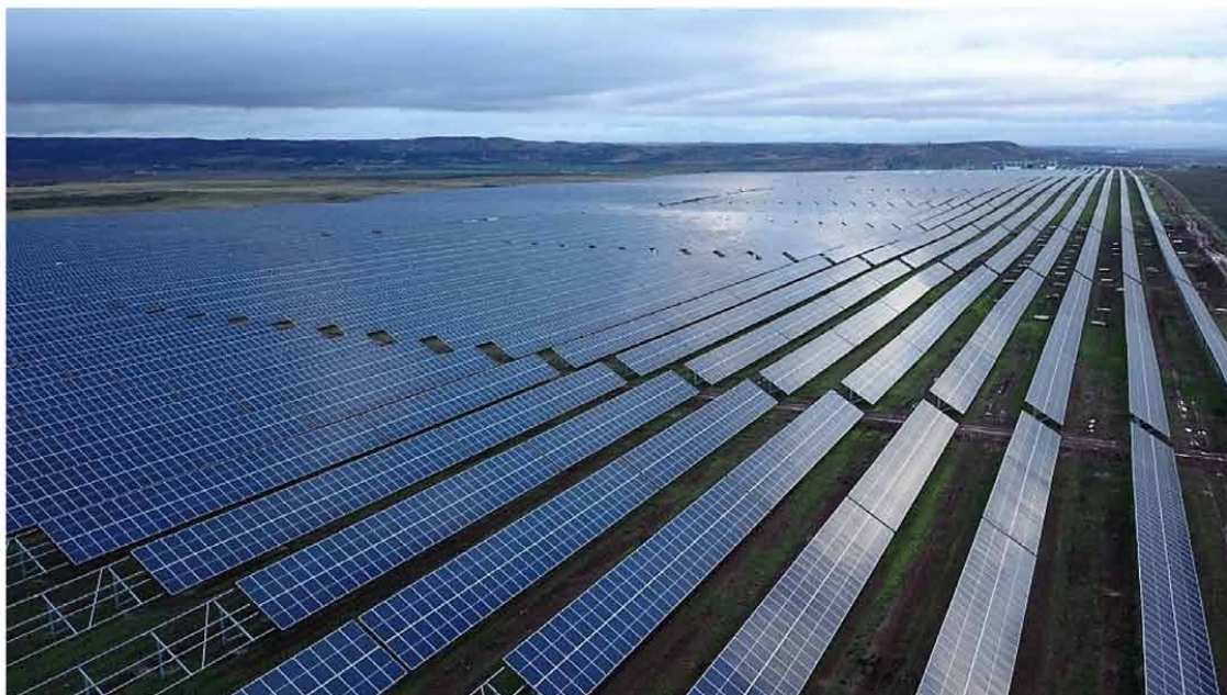
Planta fotovoltaica El Carpio.
