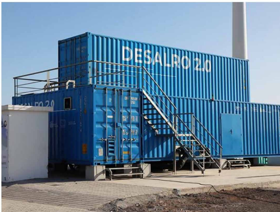
DESALRO 2.0, la planta desaladora que ha llegado a Canarias. (Cedida)
